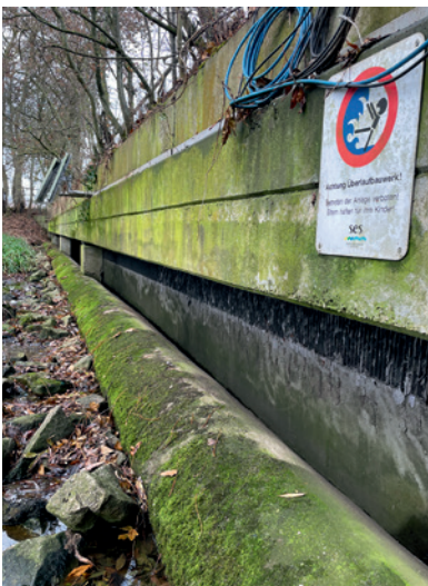
Schwelle einer Mischwasserentlastung in Stuttgart-Möhringen
